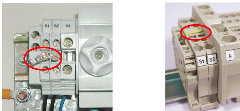
Fig. 5-3 .- Puente para cortocircuitar el secundario del transformador de corriente (TC)
