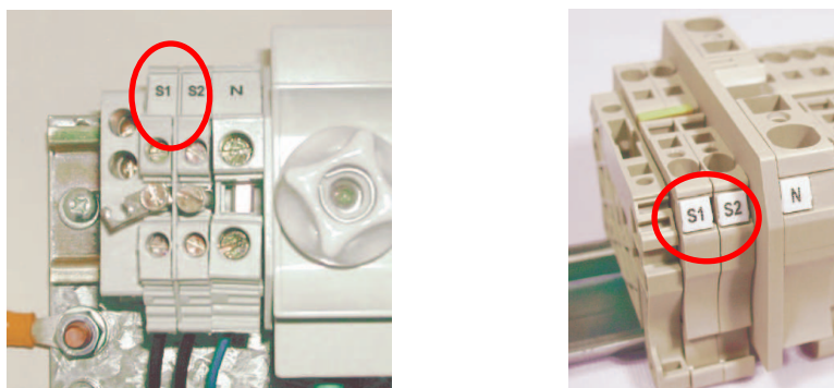
Fig. 5-4 .- Terminales de conexión del TC y Neutro en caso de ser necesario
